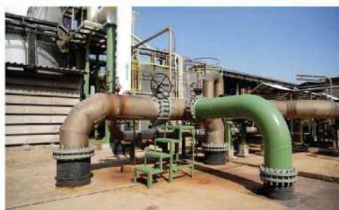
โรงไฟฟ้า IRPC | IRPC power plant
